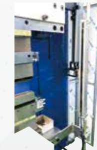
ATC動作時に、作業者の安全を確保します。
